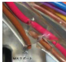
被害痕跡の一例
